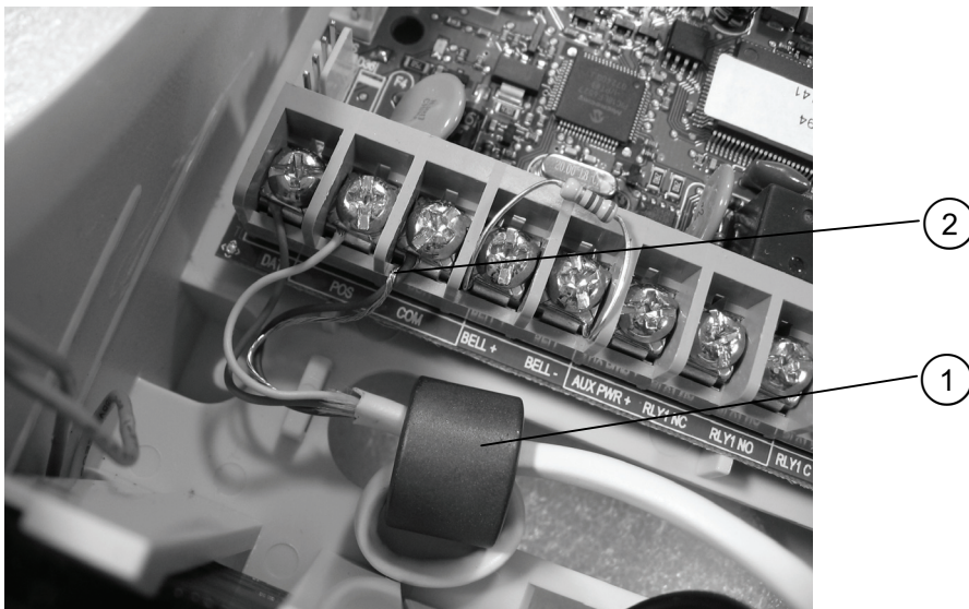
Figure 9. Bornier de connexion du centrale.
